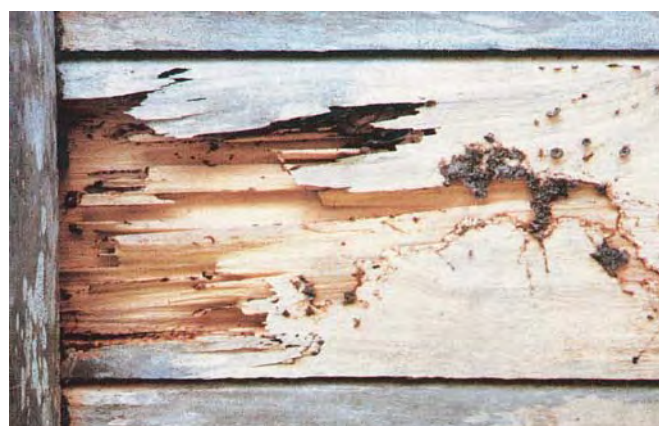
Dégâts causés par des Nasutitermès.
